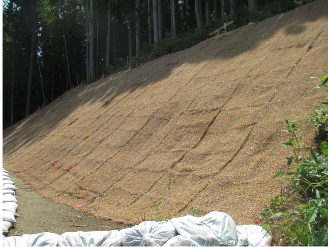
かまくらマット・館地区急傾斜 .JPG
