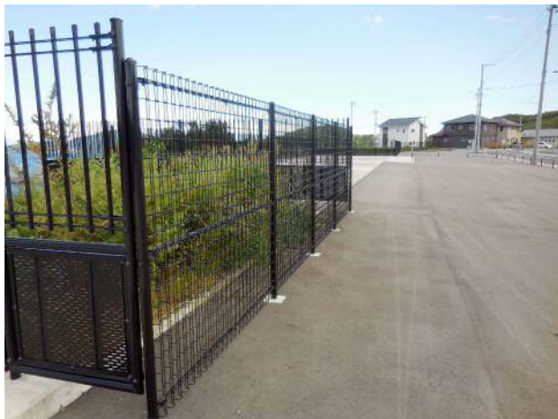
転落防止兼用フェンス.JPG
