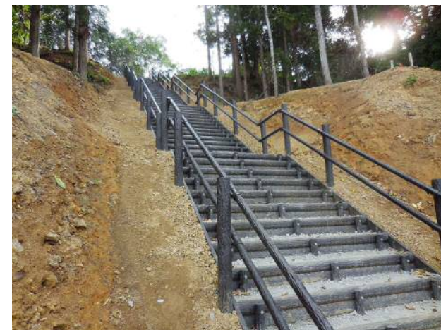
擬木フラ 避難路階段手摺.JPG
