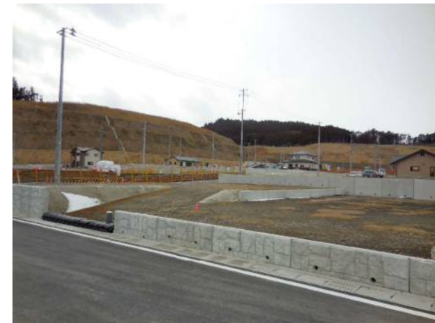
コンクリート集水蓋(ファイコン)陸前高田市市区画整理事業.JPG
