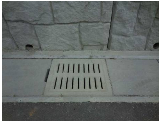
コンクリート集水蓋(ファイコン)陸前高田市市区画整理②.JPG
