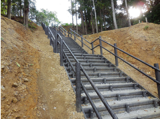
擬木プラ 避難路階段手摺.JPG
